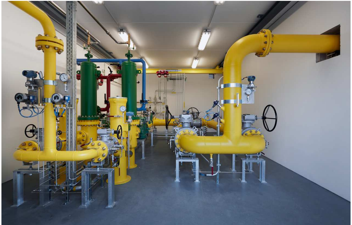
Poste de détente et comptage de Saillon inauguré en septembre 2016.
