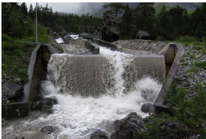
Prise d'eau de la Derbonne – déversement lors des crues 2014
