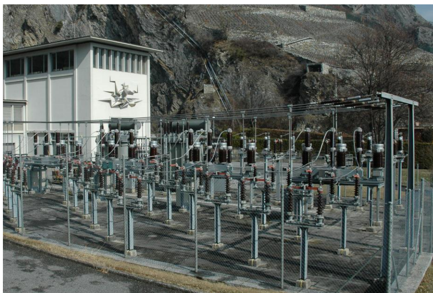
Vue du poste de coupure à la centrale d'Ardon
