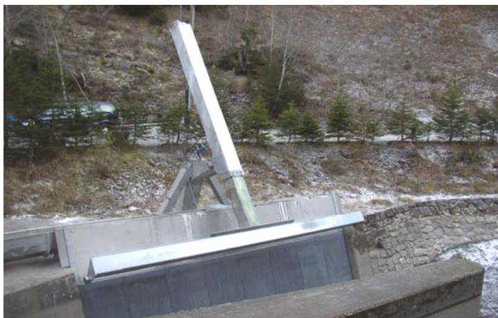
Dégrilleur automatique à la prise d'eau de la Morge
