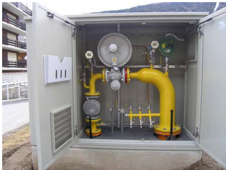
poste de détente, Nendaz
