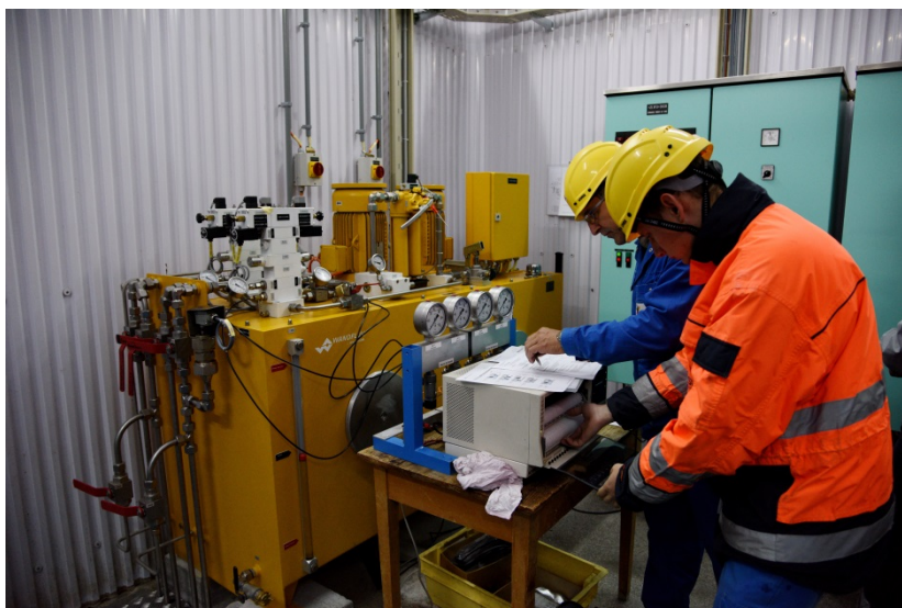
Essai annuel de la vanne de fond de Zeuzier
